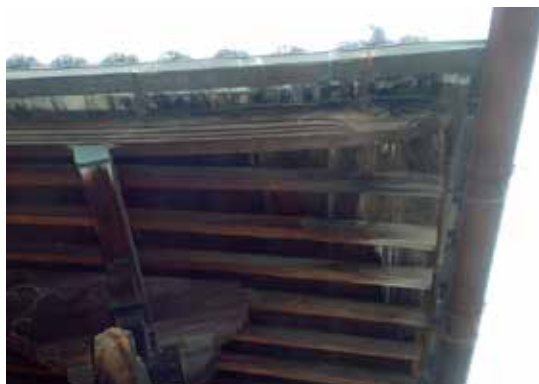
雨漏りによって腐食している向拝部分
