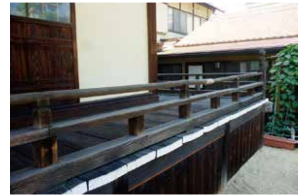
老朽化している回廊
