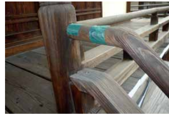
破損している欄干
