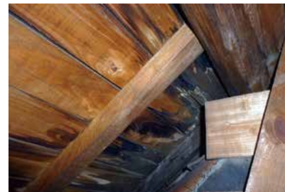
雨漏りによって腐食している天井裏
