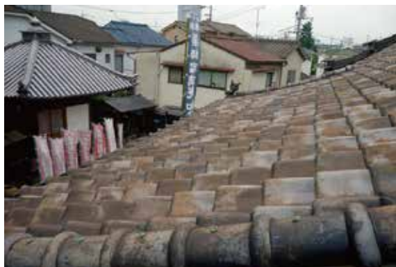
赤褐色に汚れている屋根瓦
