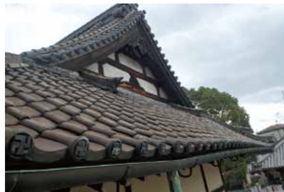
垂木の老朽化により波打っている状態の軒
