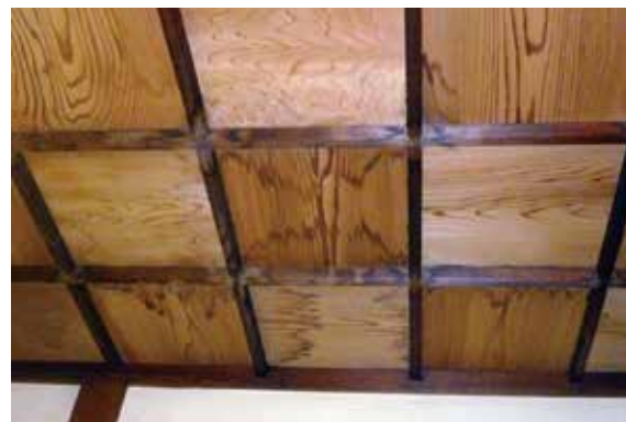
雨漏りによる天井面のシミ
